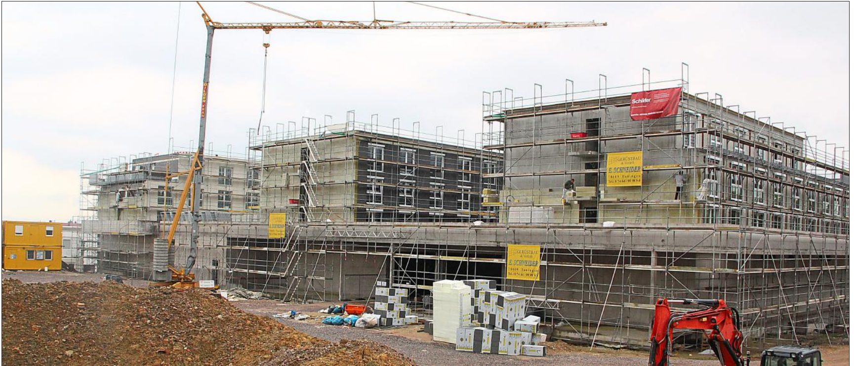
Der Blick von der Villinger Straße zeigt die Größe des geplanten Wohnkomplexes in Schweningen. Auf dem Areal stand die Ziegelei, dann der Bauhof. Fotos: Kratt
